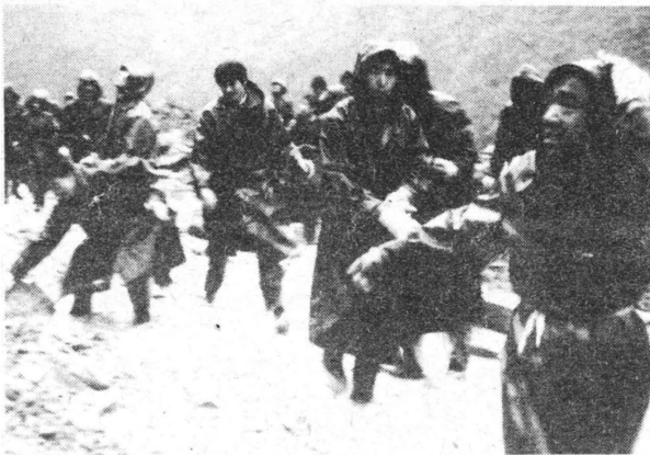
七月六日，宝成铁路北端峰高路险的“咽喉”区段，遭受暴雨袭击，凤州工务段的干部工人冒着山体落石的生命危险，清泥石、排险阻、保畅通，与大自然殊死拼搏，奏出了工人阶级战天斗地、忘我奉献的最强音。 周贤宝 摄
