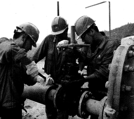
三季度以来,长庆油田采油一厂玉带集中处理站不断强化安全管理工作,并将安全管理重点放在岗位责任的落实和设备维修保养两方面,进一步促进安全管理水平提升。王庆霞 摄
