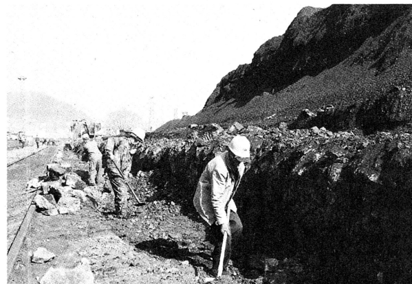
由于运输车辆装载重,装载车常年碾压,加之雨水浸泡,不久前陕煤建司统配煤台北站多处出现裂缝、垮塌。为了减少对煤炭运输的影响,公司果断采取措施,一边组织技术人员勘察现场,一边组织施工人员进行先期开挖基础。此次煤台修复项目由建设集团铜川分公司承担,工期30天,工程主要为南北站台各200米长的站台挡墙,并向外延伸3米宽的道路,工艺为混凝土浇筑而成。由于白天运煤车和火车装运繁忙,为避免对运输的影响,南北站台轮修,施工产生的土方主要集中在夜间外运。 汪琳 摄
