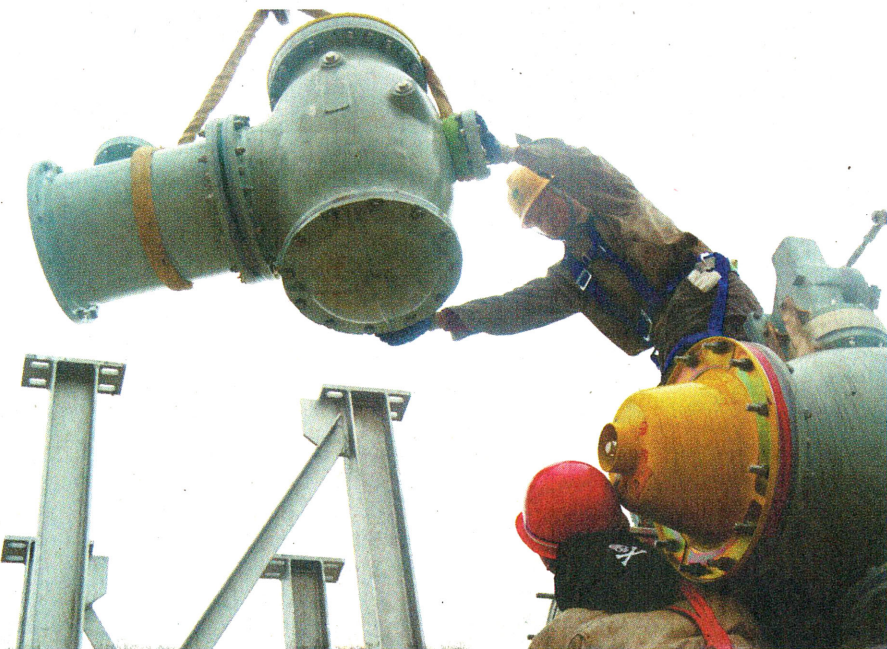
330千伏商州变电站作为商洛市区电网的第二电源,该变电站将在11月25日投运,对商洛市“一体两翼”的发展规划及经济社会发展提供可靠的电力保障。
