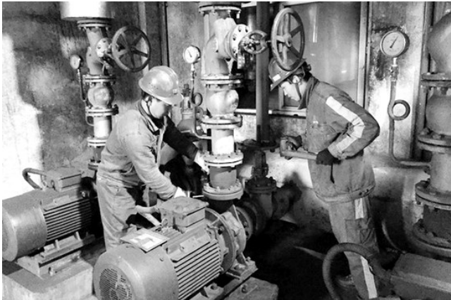
自九月下旬开始,陕北地区昼夜温差明显增大,为给广大干部职工创造一个良好的工作和生活环境,陕北矿业涌鑫矿业公司未雨绸缪,多措并举,提前对供暖设施及管网进行了全面检修和调试,确保供暖管网安全、高效、正常运行。陈亚龙 摄
