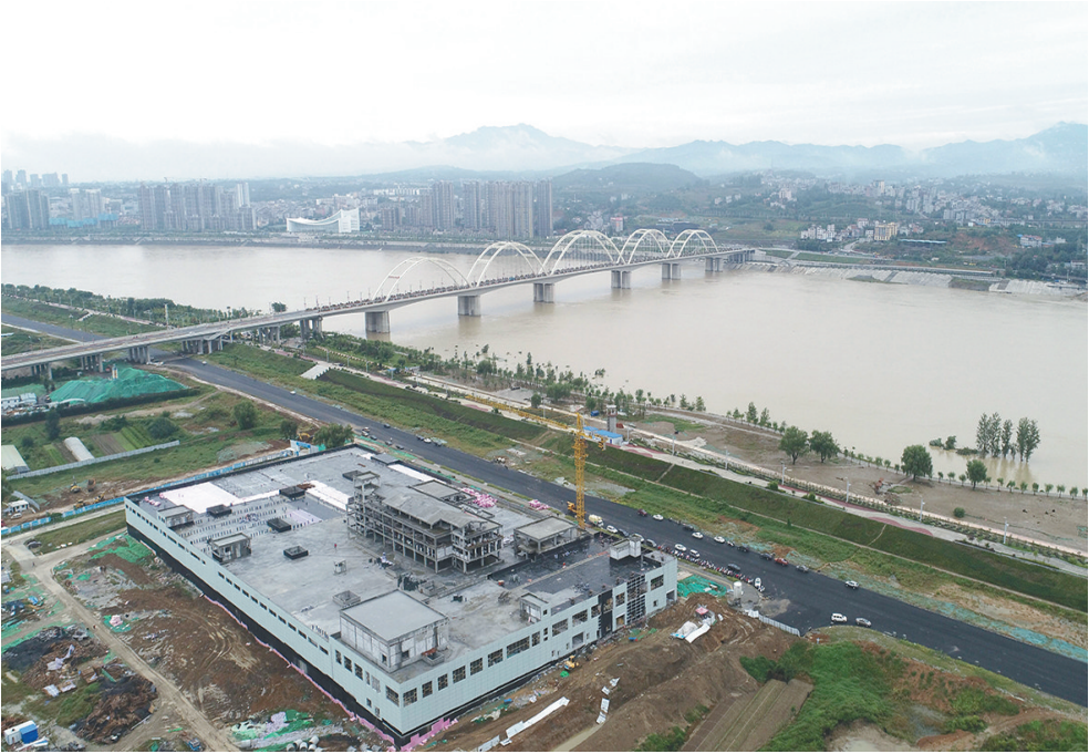
日前,由中建五局三公司承建的陕西安康中心城市水环境PPP项目江南下沉式再生水厂顺利投产运营,标志着项目正式进入商运阶段。该项目的建成投用,对改善安康城市水环境质量,提升城市人居环境,确保南水北调中线工程水质安全意义重大。 马勇 摄
