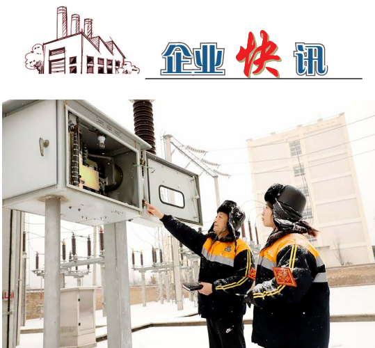
2月14日,陕北普降大雪,绥德供电段立即启动除雪打冰应急预案,加强设备巡视,及时处理设备隐患,为春运提供优质服务。图为该段绥德变电所值班人员冒雪巡视变电设备。 李现明 摄
